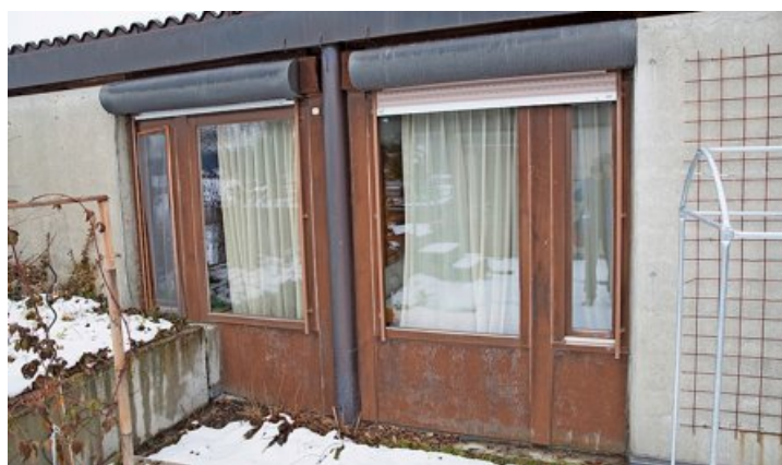
Der Zahn der Zeit hat den Gebäuden sichtlich zugesetzt.
