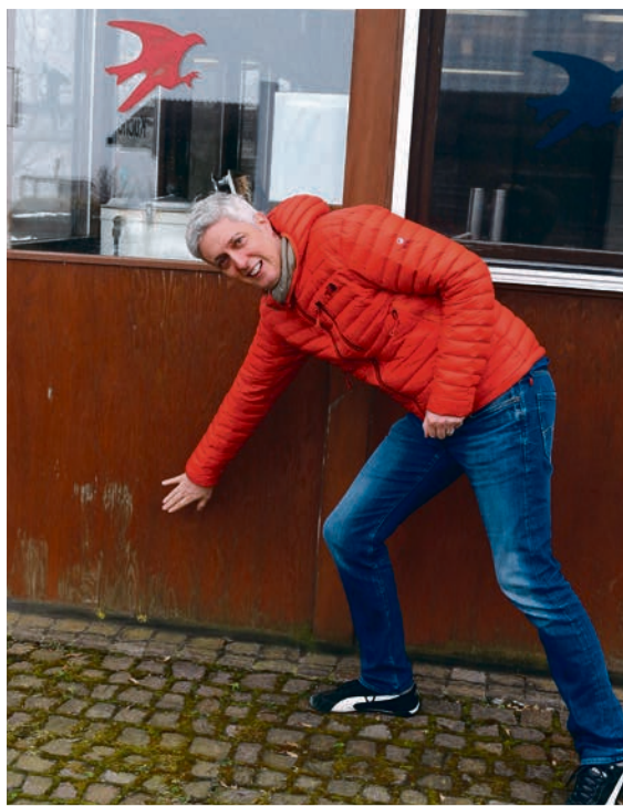
Direktor Vinzenz Miescher zeigt die Schäden an der Aussenwand der Küche. | Fotos: Monika Gfeller
