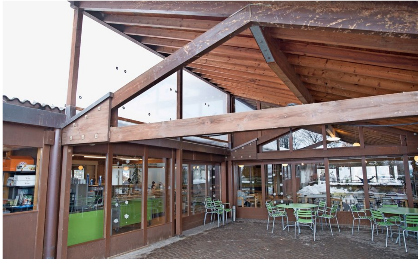
Die Gebäude von Bernaville sind in einem schlechten Zustand. Sie müssen dringend saniert und umgebaut werden.
